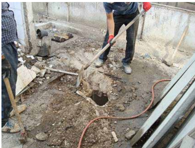
شکل ۳- ماده ۲۱۸ ضرورت پوشاندن سوراخ‌های منتهی به طبقات پایین هنگام تخریب دیوارهای داخلی و خارجی.
