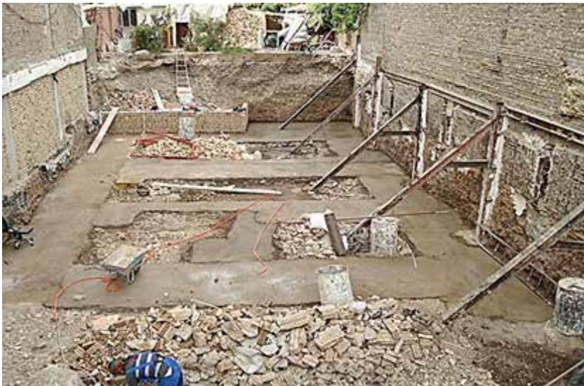
شکل ۱۳- تمیز و مسطح کردن مسیرهای آرماتور بندی با بتن مگر یا ملات ماسه سیمان، عدم اجرای کرسی چینی، قسمتهای فاقد ملات ماسه سیمان (بتن مگر) قالب بندی خواهند شد.
